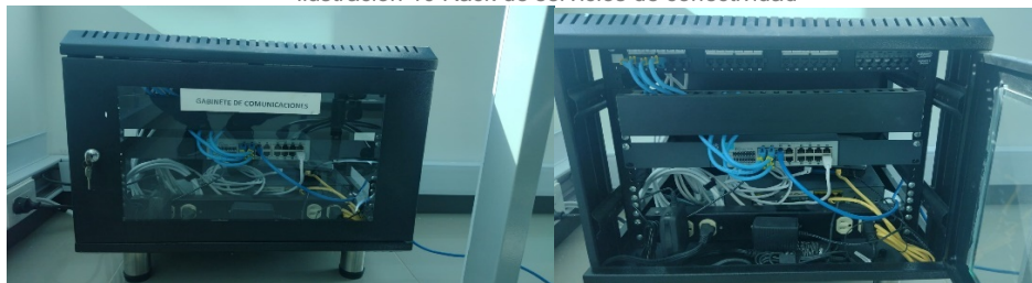
Ilustración 10 Rack de servicios de conectividad
